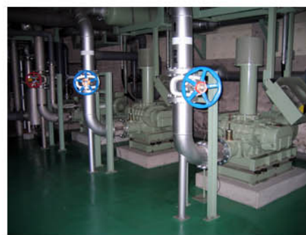
▲ 曝気ブロー室
