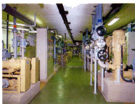
▲ ポンプ室（地下）
