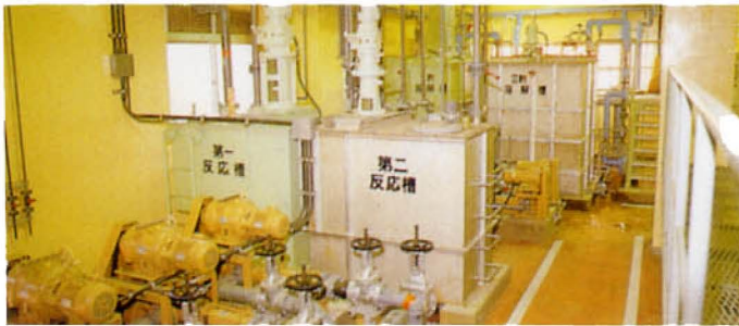
▲脱水剤溶解設備
