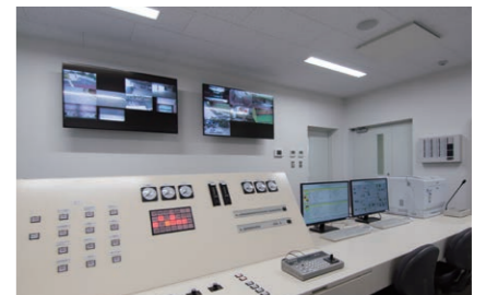
施設全体の処理ラインを管理します。処理ラインの運転は全てここから行い、機器の状態や処理の状況をモニターで監視します。
