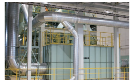
施設内の各所で集められた粉じんをバグフィルタで除去し、活性炭を充填した脱臭装置により臭気を除去します。
