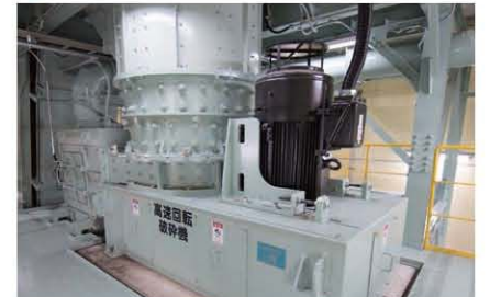
高速で回転するブレードで粗大ごみ・不燃ごみをたたき・砕き、グラインダで細かく破砕します。
