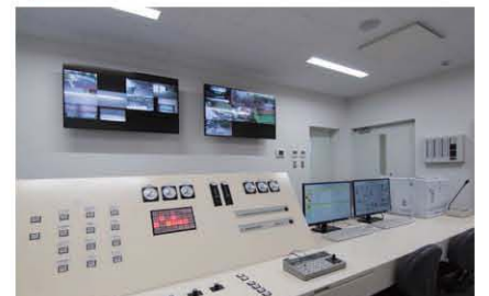
施設全体の処理ラインを管理します。処理ラインの運転は全てここから行い、機器の状況や処理の状況をモニターで監視します。
